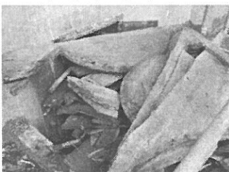
Zniszczone elementy konstrukcji drewnianej latarni nad kopułą kaplicy Aniołów Stróżów
