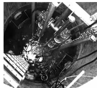
Przepompownia P3 w trakcie uruchomienia sprawdzającego
