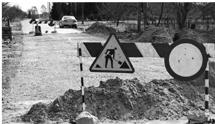
Na ul. Południowej trzeba położyć asfalt
