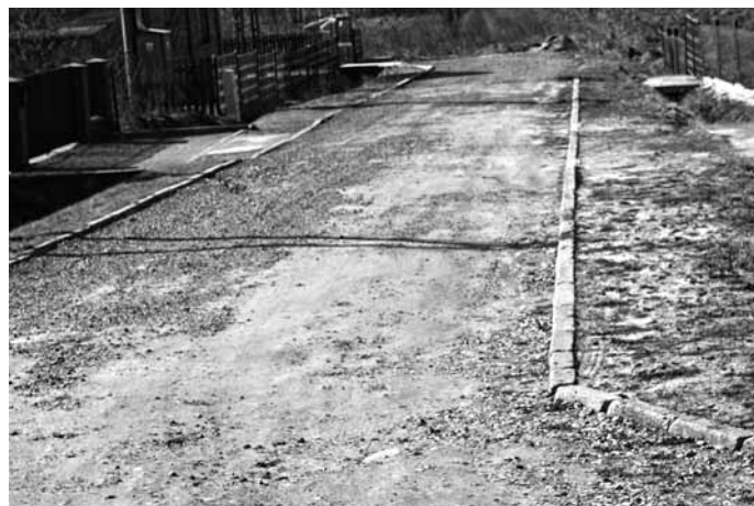
Droga w kierunku młyna wymaga remontu
