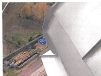
Instalacja odgromowa /mocowanie do blachy na sygnaturze/
