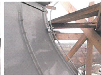
Przewód ocynkowany instalacji odgromowej mocowany na rąbku stojącym blachy poszycia
